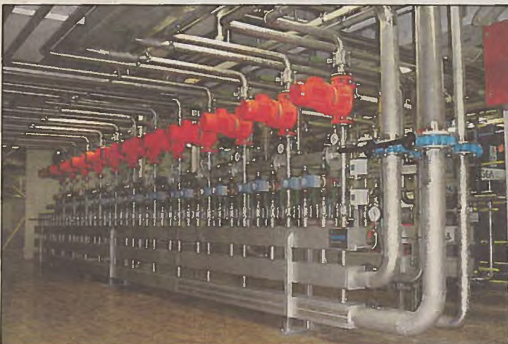
Diese Anlage zum Conchieren (Heizen/Kühlen) von Schokolade lieferte Wagner für die Kraft-Fabrik im badischen Lörrach.
